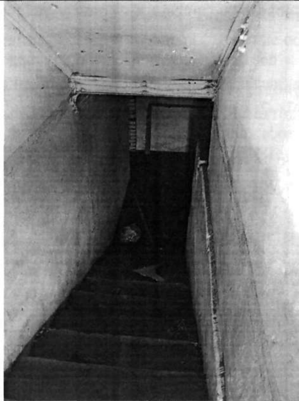
Фото 2, 3, 4. Обзорное фото. Затоплен подвал подъезда. На момент обследования уровень воды от чистого пола подвала составлял 0,5 м.
